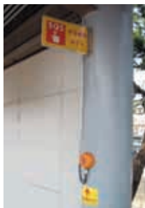
ホーム異常通報装置
