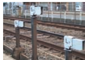
踏切障害物検知装置
