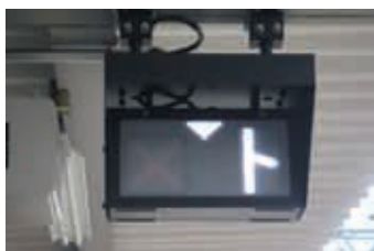
戸閉合図装置(ホーム上屋に設置)
