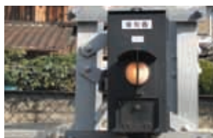
作業用列車接近報知器
